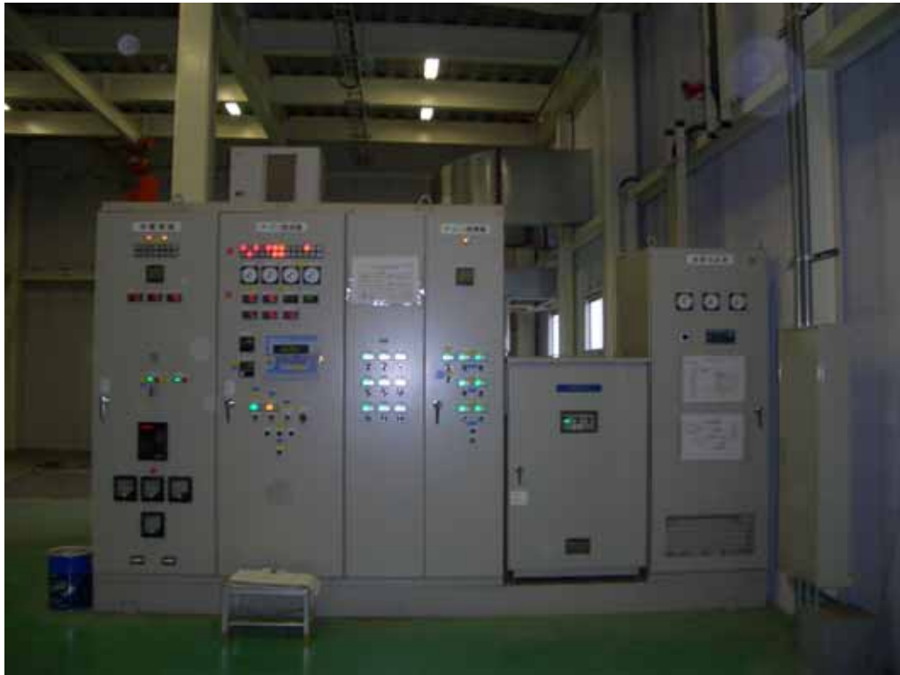
写真 5.4.3-9 #3 蒸気タービン発電機の制御装置
