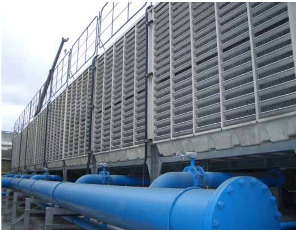
写真 5.4.3-10 #3 蒸気タービンの復水冷却塔外観
