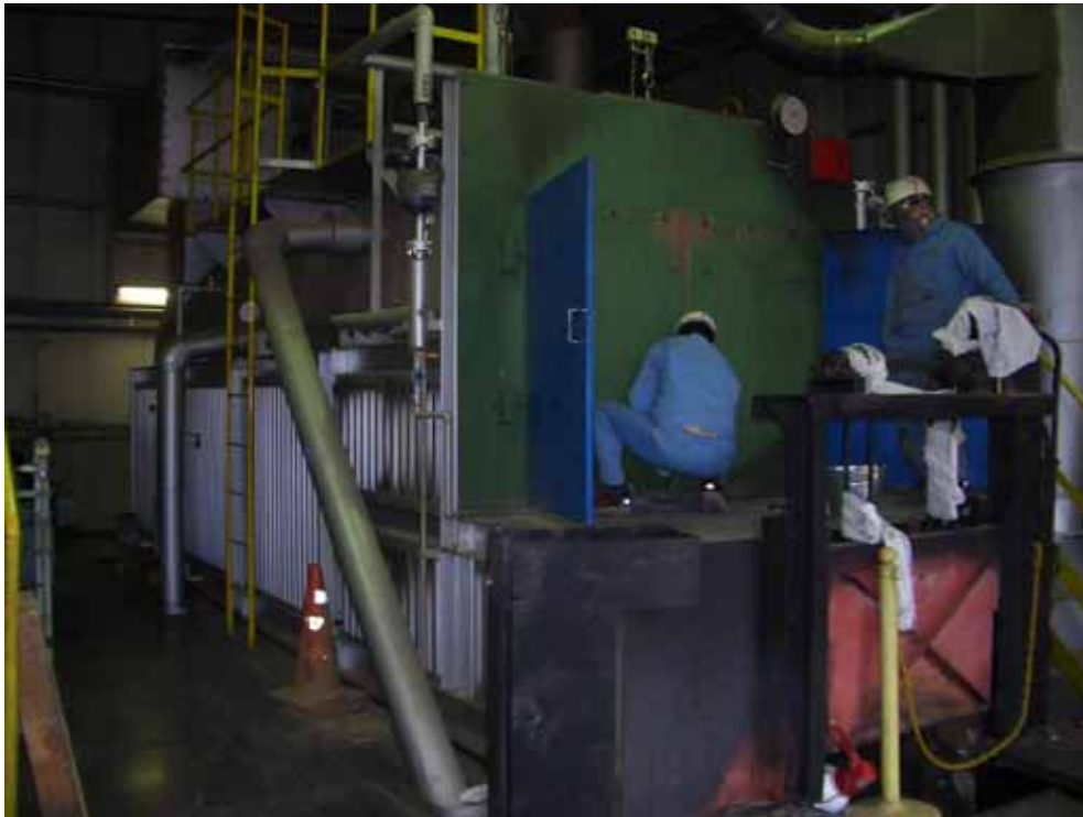
写真 5.4.3-5 #2 ボイラ缶前 (蒸発量 5t/h)
