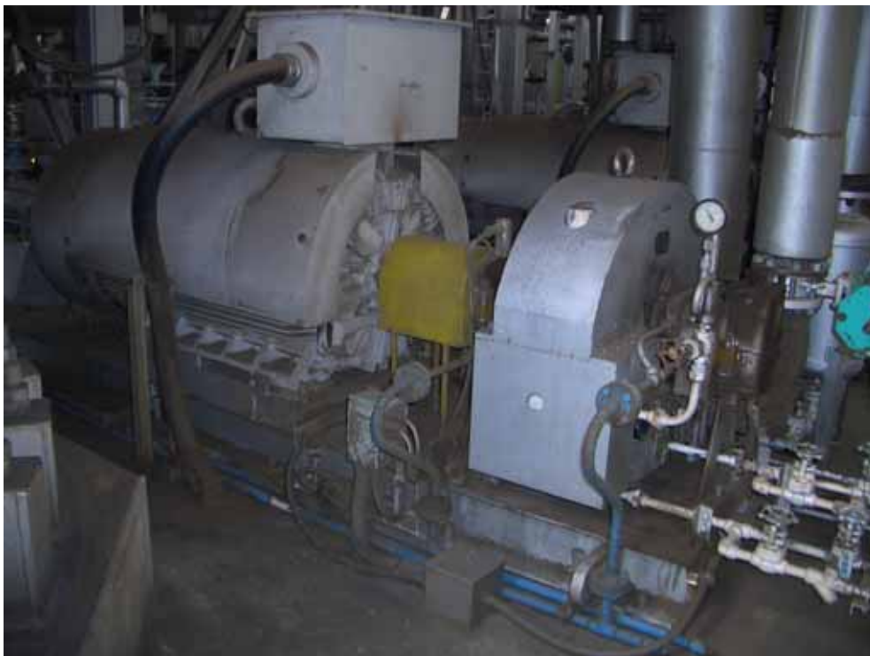
写真 5.4.3-6 #2 背圧式蒸気タービン発電機 (電気出力 330kW)
