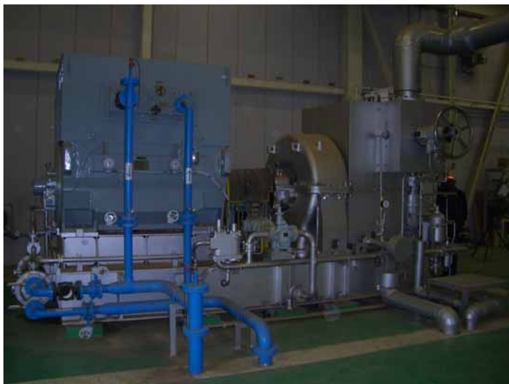
写真 5.4.3-8 #3 蒸気タービン発電機 ( 電気出力 2000kW )
