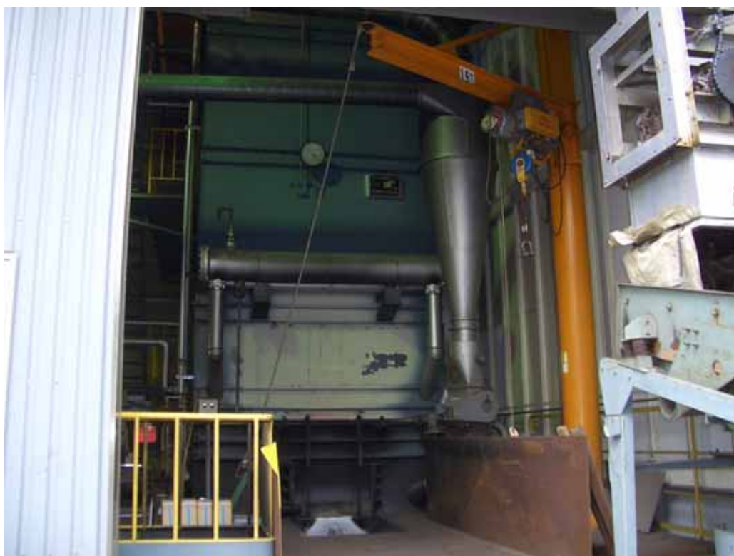
写真 5.4.3-7 #5 ボイラ正面 ( 蒸発量 13t/h )
