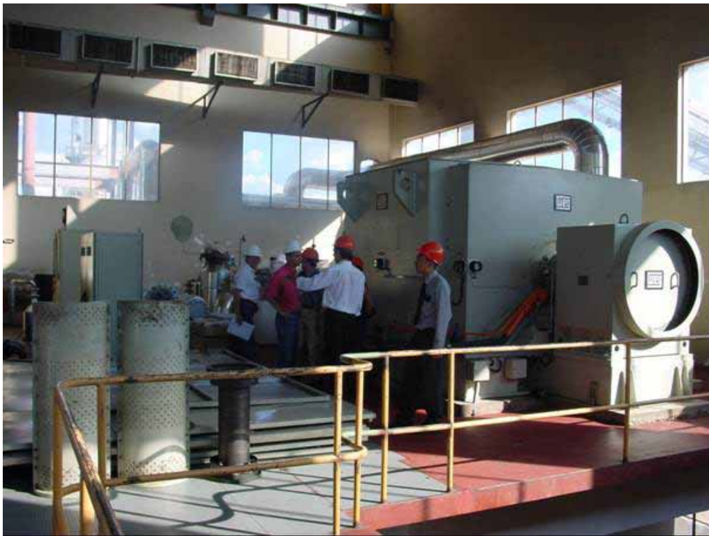
Santa Adelia にて：新型のボイラ（25MW クラスの蒸気タービン、発電機）
