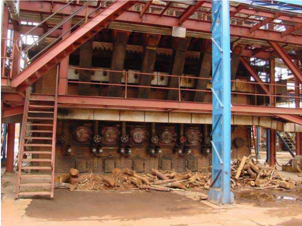
稼動中の 21kgf/cm 2 旧式ボイラの例（Goias 州 Jalles do Machado 工場）
