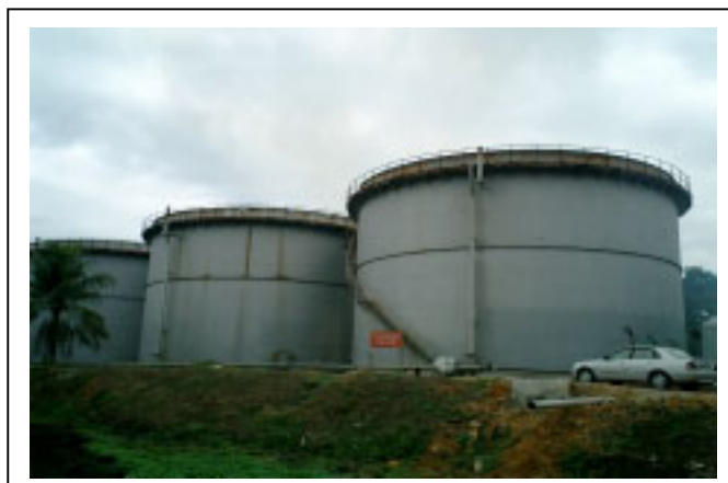
図表 1 - 3 開放型廃液処理タンク
