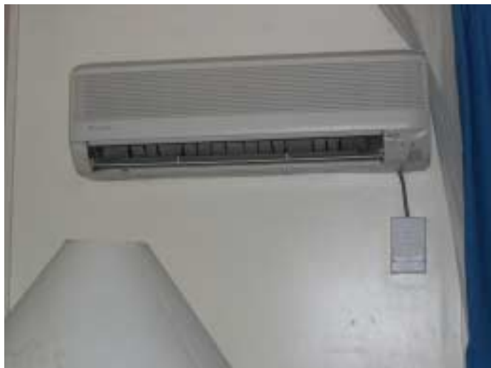
写真3 客室のエアコン
