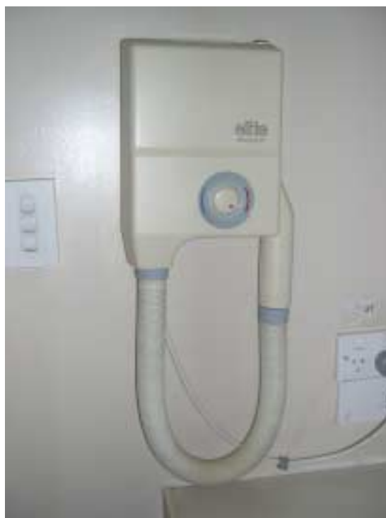
写真4 客室のドライヤー
