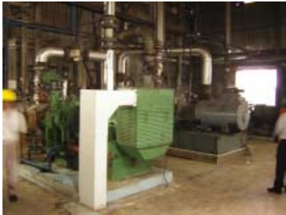
背圧式タービン発電機 (ボイラーの後に設置)
