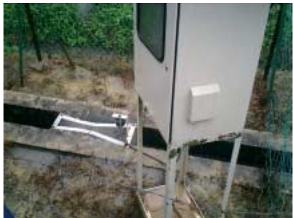
P O M E 処理水流量計 (ラグーンの後) に設置)
