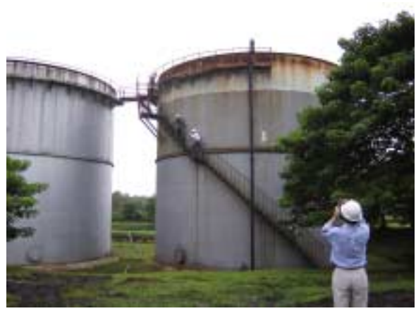
開放型消化タンク (1,500m 3 /基)
