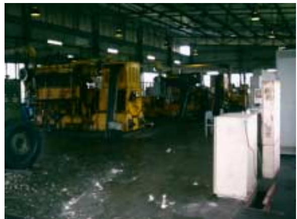
ディーゼル発電機 (隣接する T N B 発電施設)
