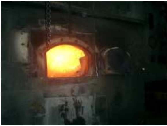
ボイラー(燃料はF F Bから発生する繊維、殻)
