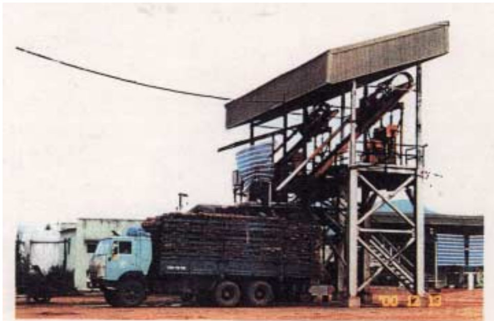
南部：ビン・ホア第2工場・サトウキビサンプリング設備
