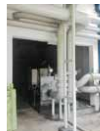
工場空調及びプロセス冷却用冷凍機(インドネシア)
