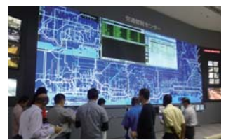
交通管制センター
