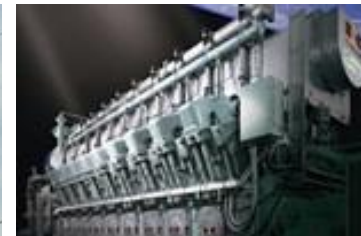
コージェネレーションシステム (豊田通商) コージェネレーションシステム： 川崎重工業製
