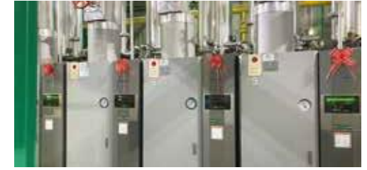
貫流ボイラー (インドネシア) DIC
