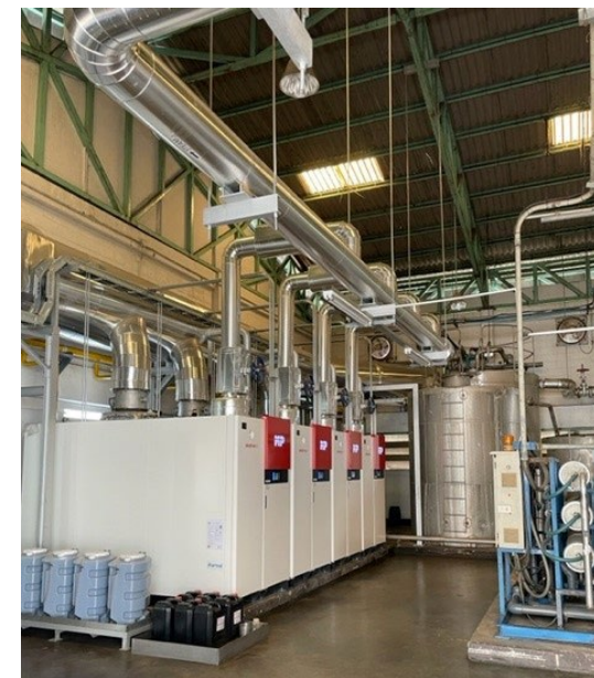
高効率貫流ボイラ
