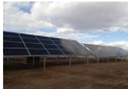
太陽光パネル
