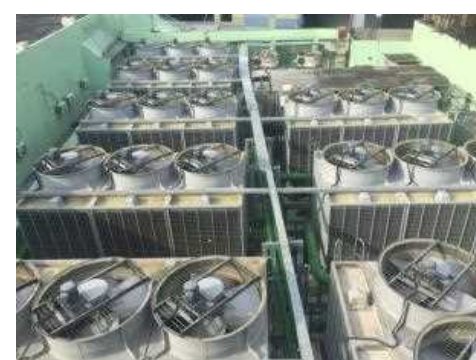
更改後冷却塔
