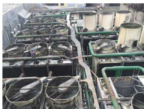
更改前冷却塔
